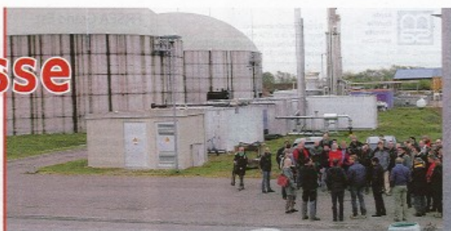
Couvrant les besoins en chaleur et gaz de 5 000 foyers, le site Badenova de Grissheim injecte son biogaz dans le réseau de distribution. © DL
