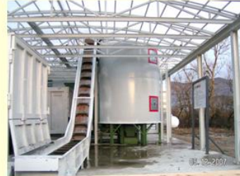
Installation de séchage
